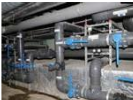
Installation géothermique des Grands Bains du Monétier.
